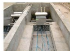
马鞍山王家山污水处理厂
