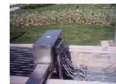
南昌朝阳污水处理厂
